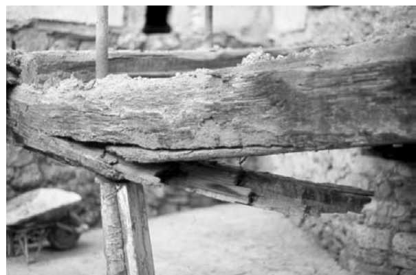
Rotura de viga en centro de vano
