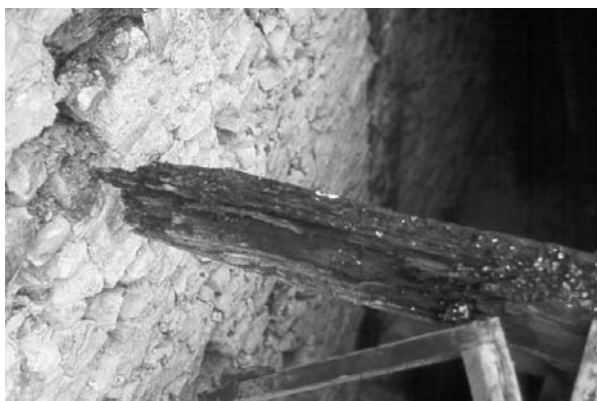
Daños en viga por empotramiento en muro
