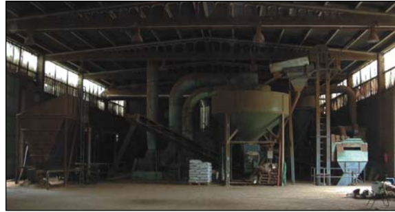
Instalación industrial de pelletizado
